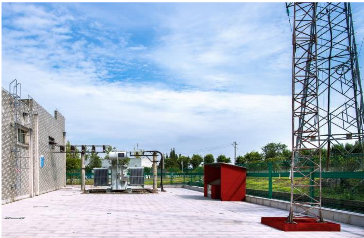
升压站安全措施完备
