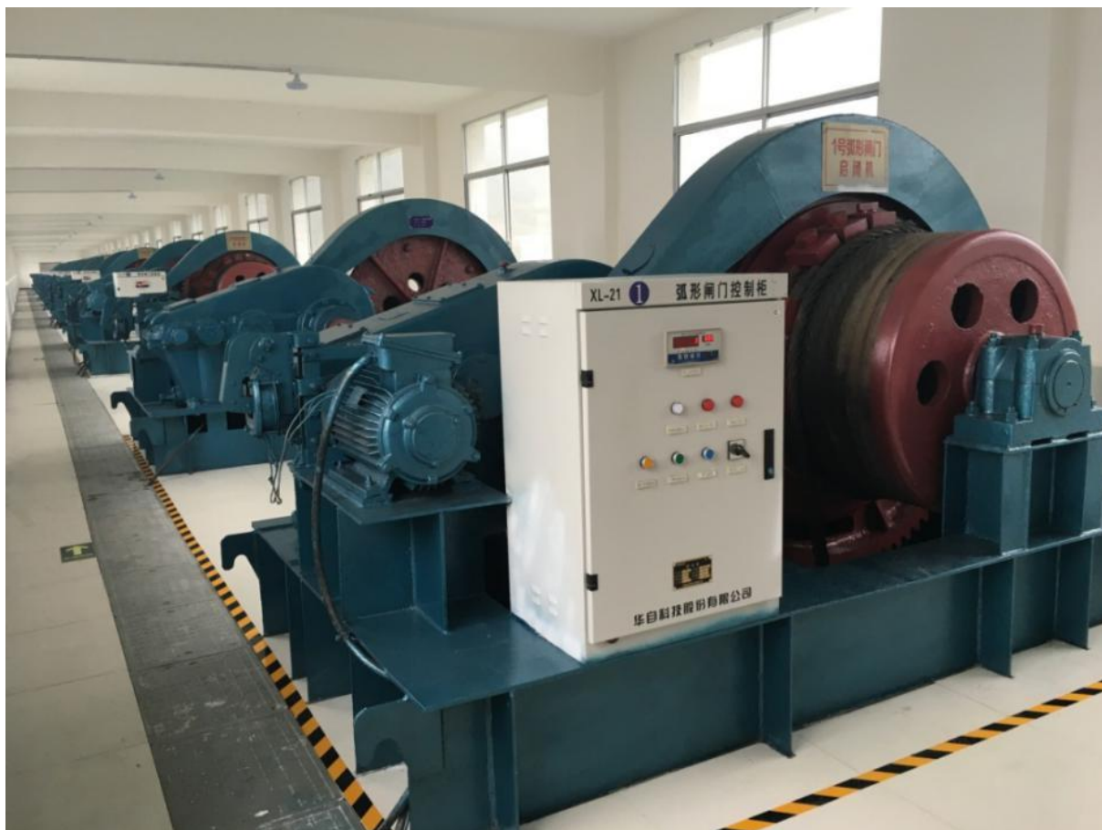
启闭机房及设备整洁规范
