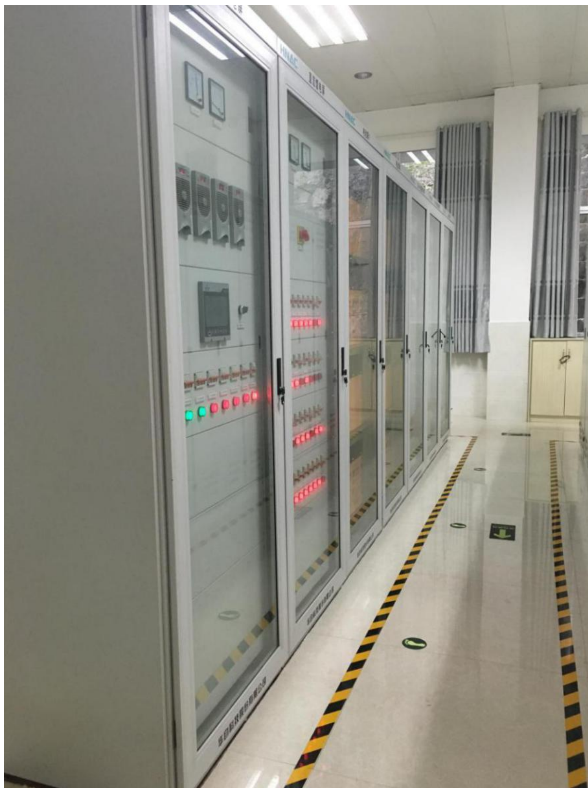
厂用配电室整洁规范、巡视路线清晰醒目
