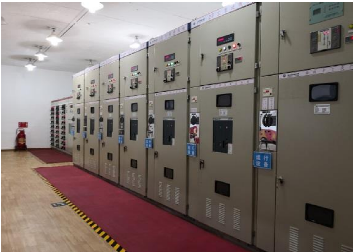
主变进线控制柜整洁规范
