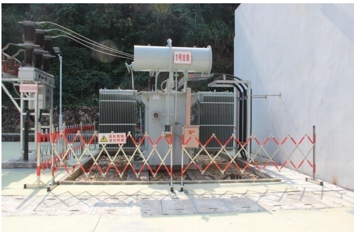
主变安全措施完备
