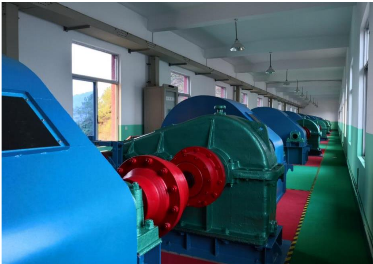
启闭机房及设备整洁规范
