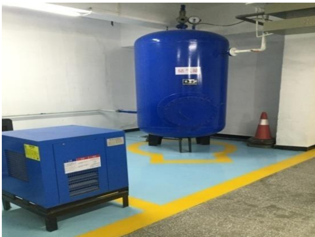
储气罐设备整洁规范
