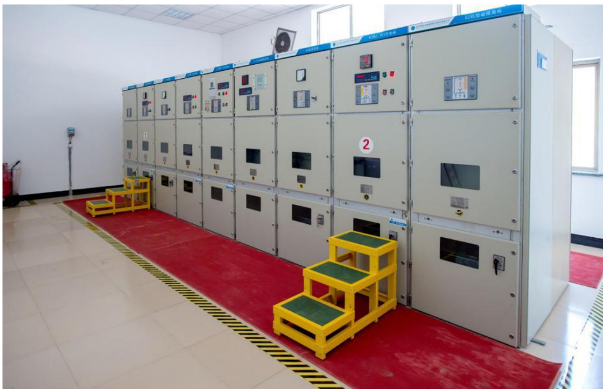
高压开关柜室整洁规范
