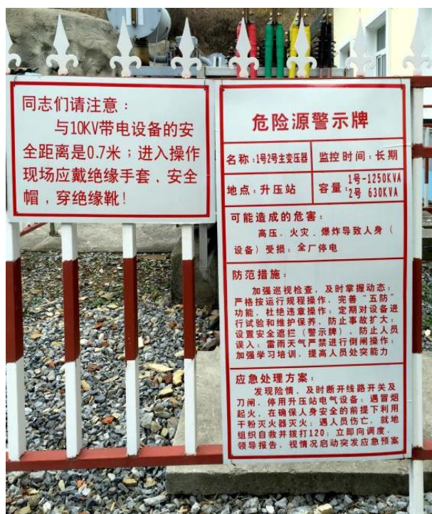
主变危险源警示牌清晰醒目
