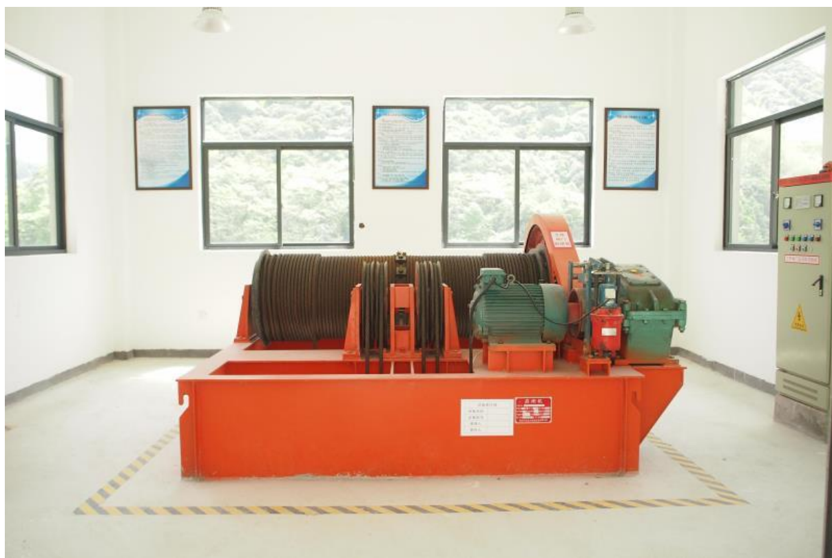
启闭机房及设备整洁规范
