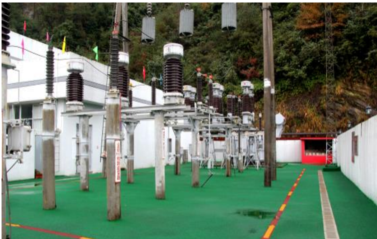
升压站封闭管理
