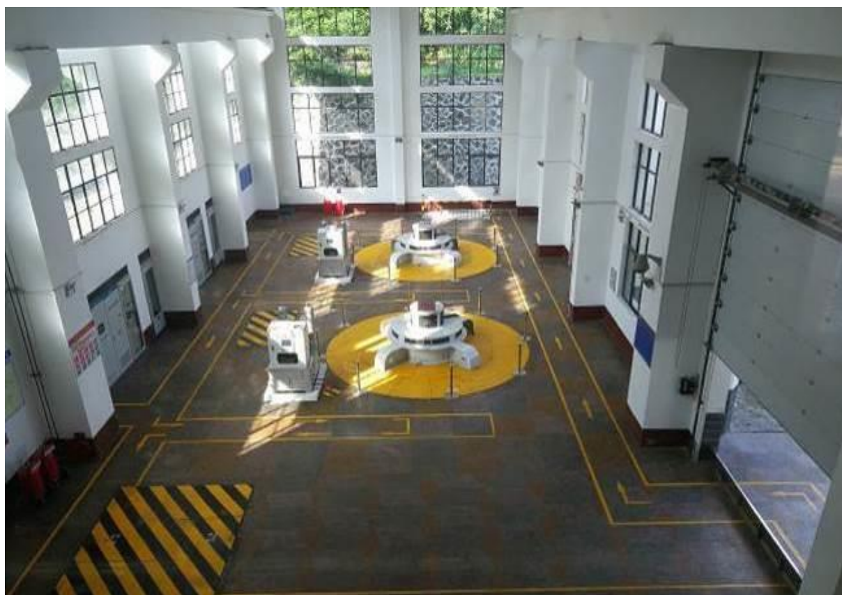
发电机层整洁规范、巡视路线清晰醒目
