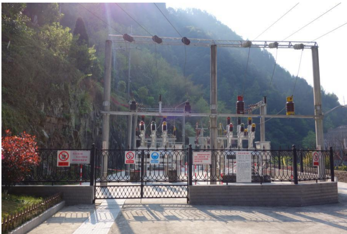
升压站封闭管理
