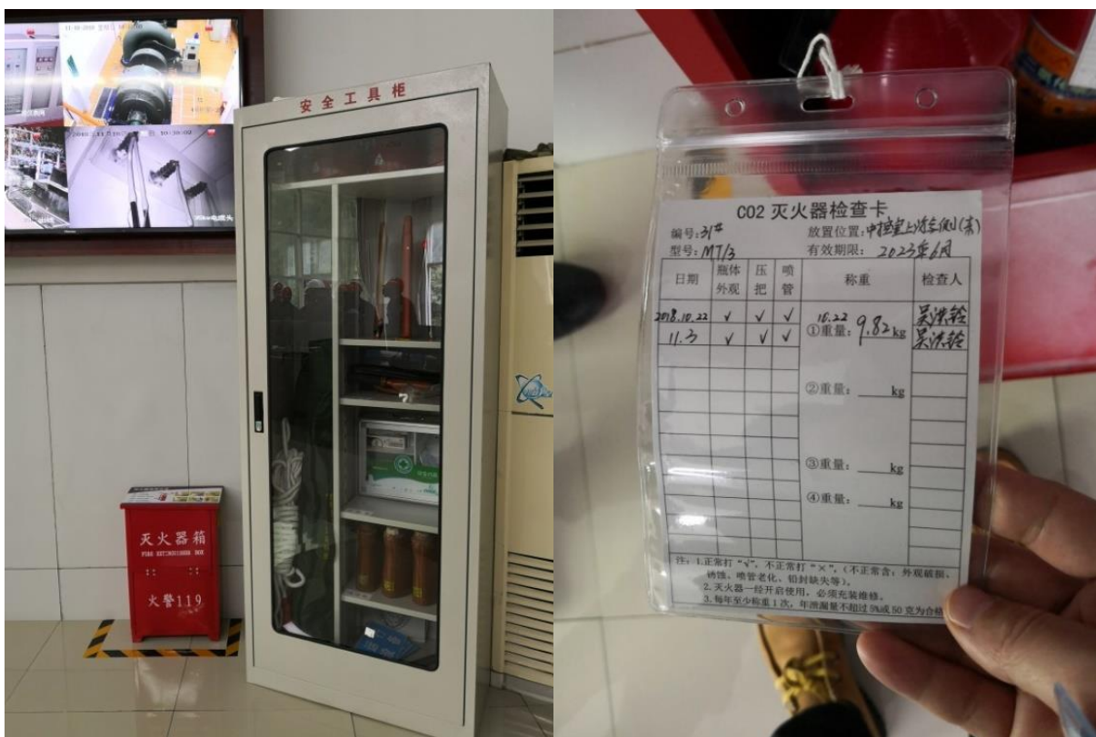
灭火器及安全工具箱醒目有效
