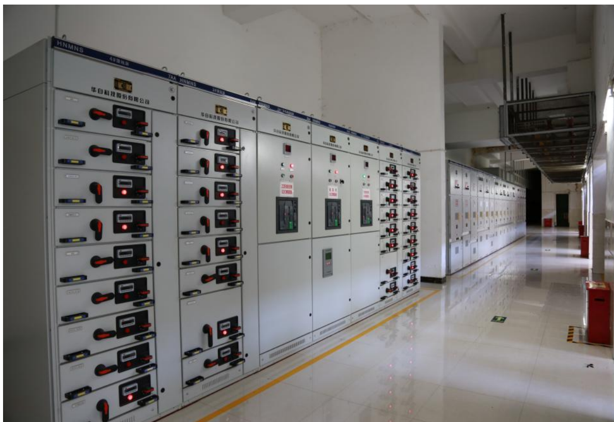
进线屏及馈线屏室整洁规范、巡视路线清晰醒目
