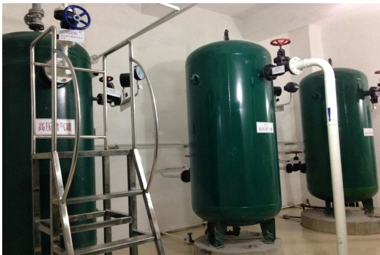
压缩空气储罐整洁规范
