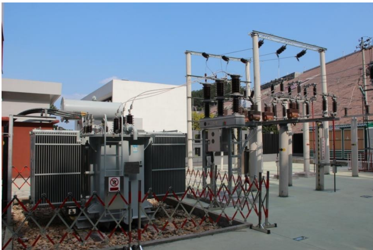
升压站安全措施完备
