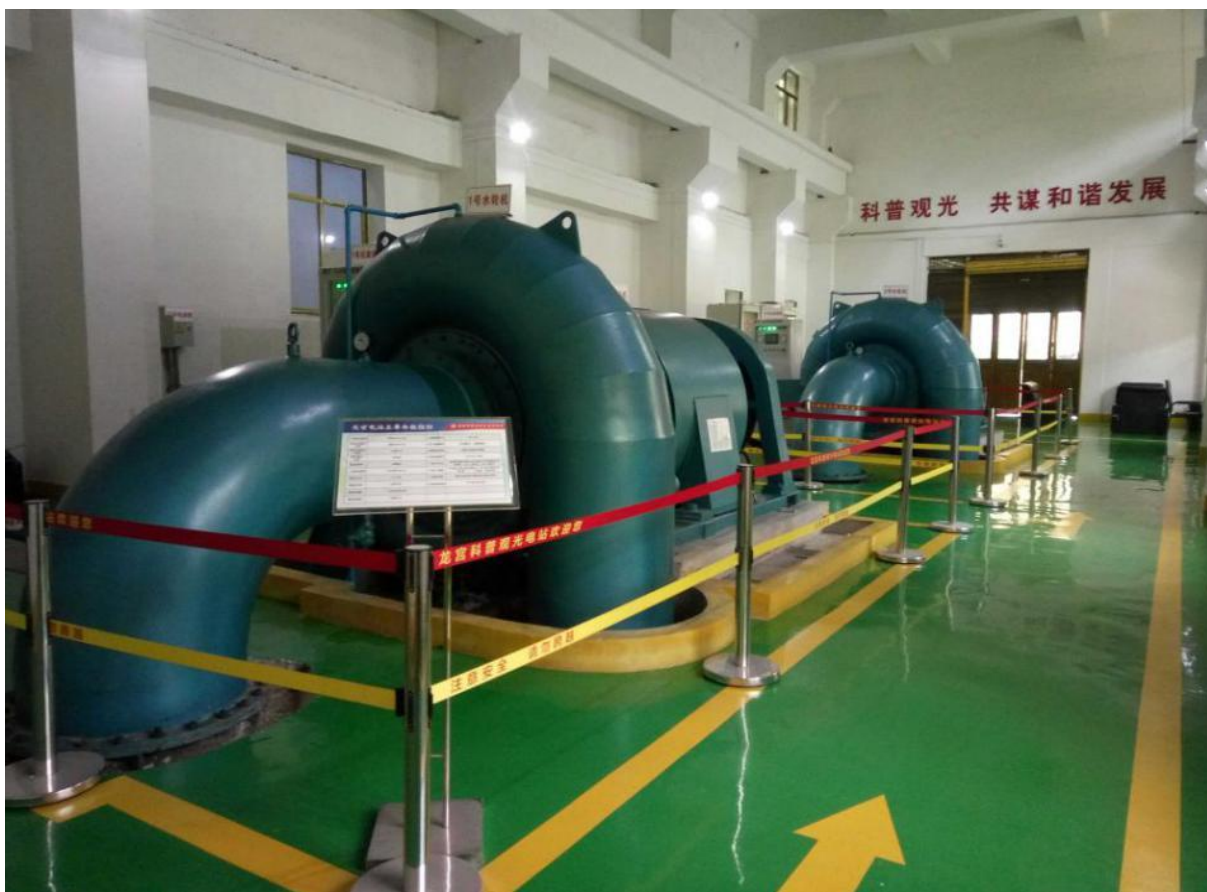
发电机层整洁规范、巡视路线清晰醒目
