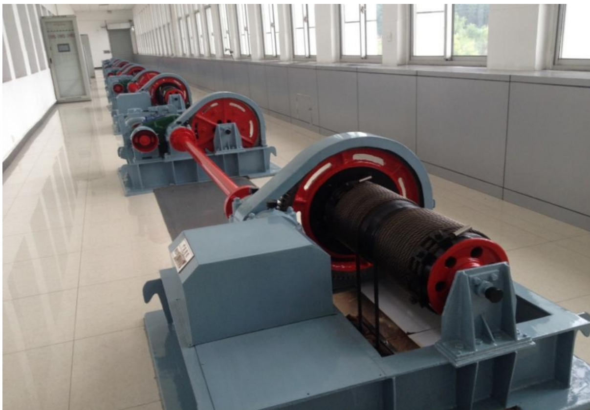
启闭机房及设备整洁规范
