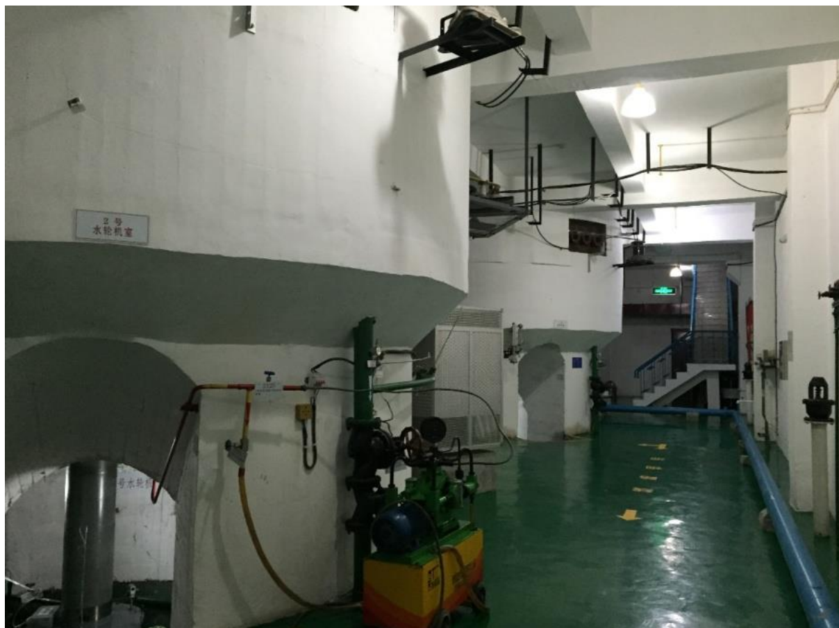
水轮机层设备整洁规范、巡视路线清晰醒目
