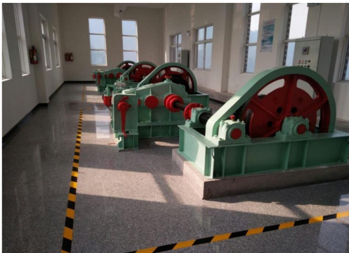
启闭机房及设备整洁规范
